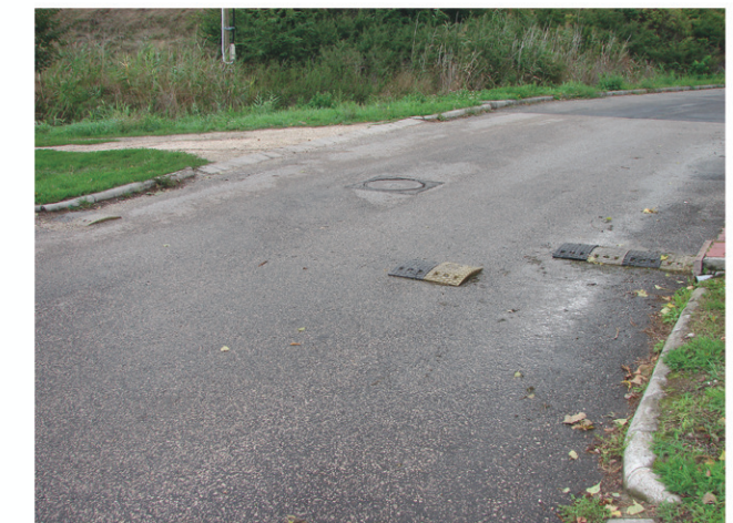
Aszfaltút szegéllyel, fekvőrendőr maradványaival
