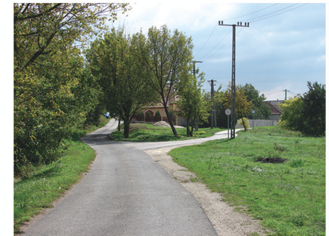
Aszfaltút hiányzó szegéllyel, kopottas padkával
